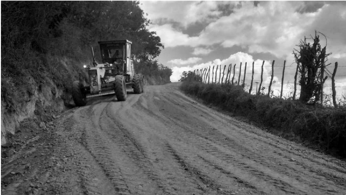
Foto 04: compactação (sem controle) se dá pelo tráfego das máquinas e veículos
